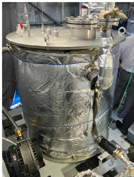
凝縮水タンク
