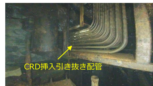
③：CRD挿入引き抜き配管(南西)
