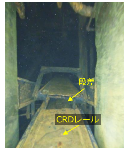
④ : CRDレールの段差箇所
