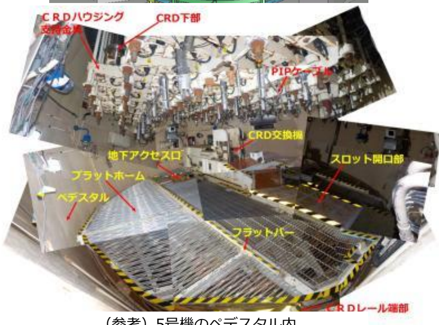
(参考) 5号機のペDESTAL内
