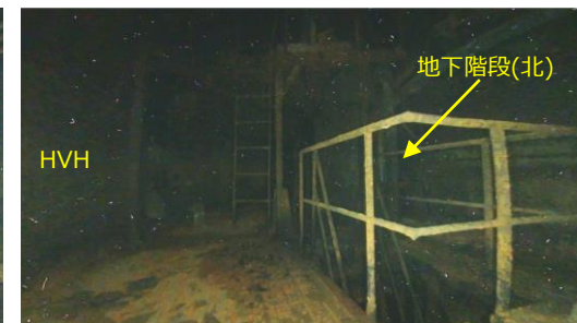
③：ペDESTAL外 北エリア
