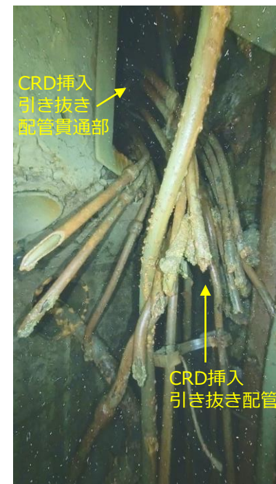
③：CRD挿入引き抜き配管(南東)
