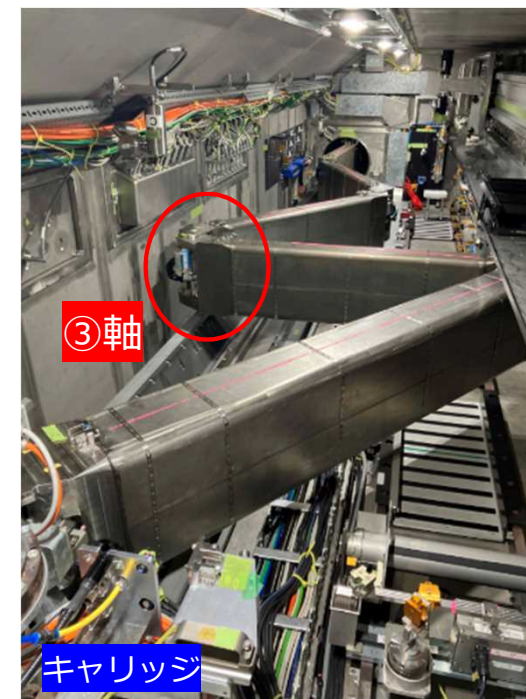
ロボットアーム動作状況 (櫛葉検証時)
