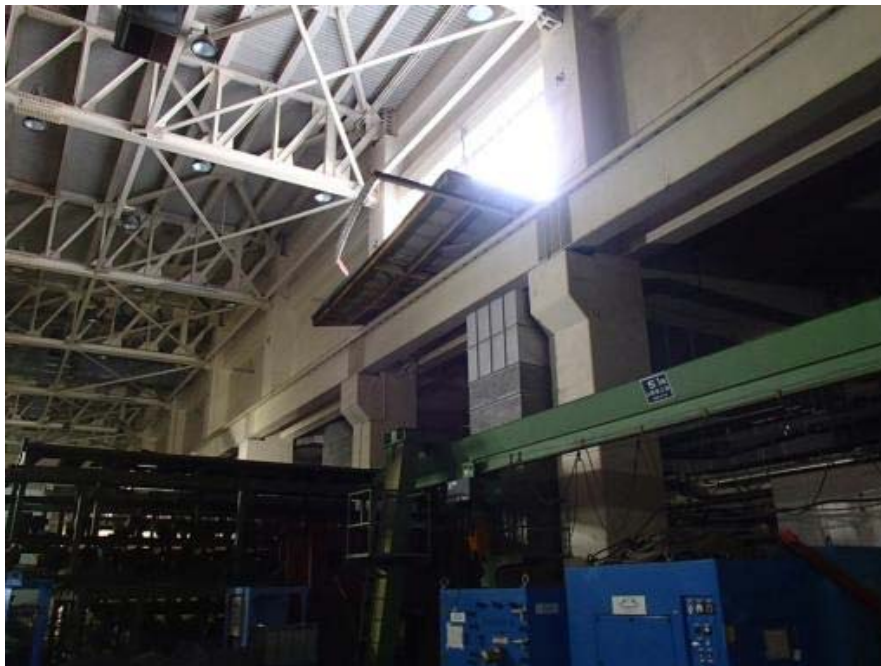
写真①：BOP損壊部分（塞ぎ前、屋内）
