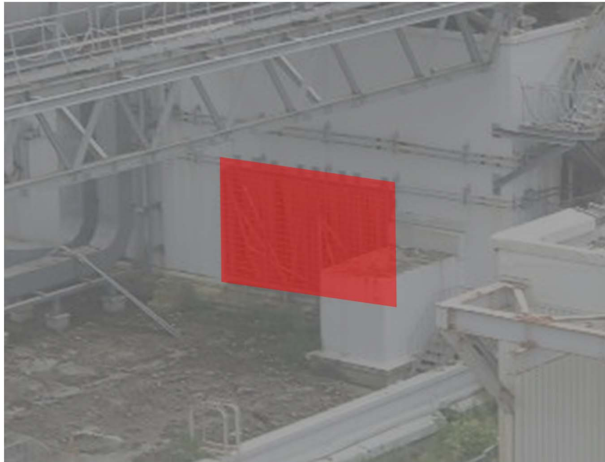
参考写真：雨水侵入箇所
