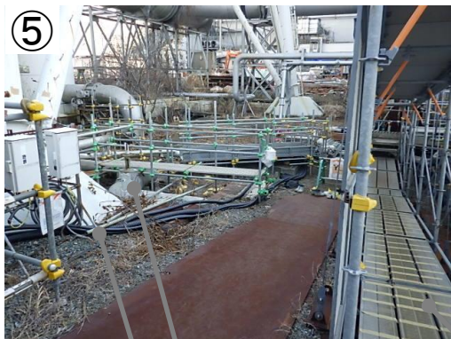
ベント弁 電気計装 歩廊
