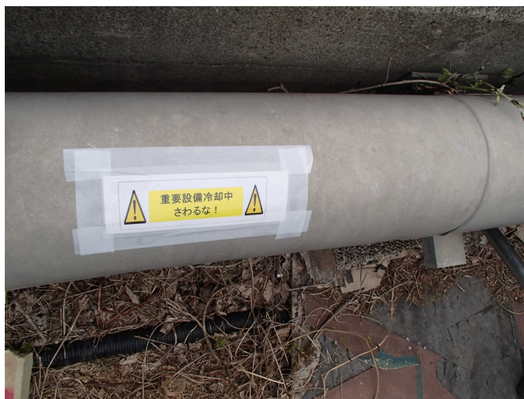
図 8 運用中の設備の損傷防止策（注意喚起の表示（例））
