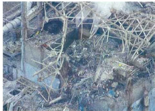
図-2.3 5階北西側の床スラブの状況
