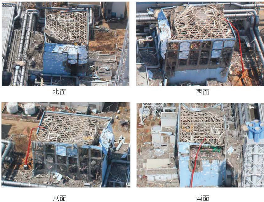
図1 損傷状況 (3月24日撮影)
