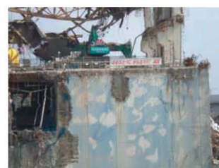
④外壁一部剥落
