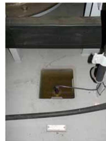
漏えい検出器の溜め升の様子
