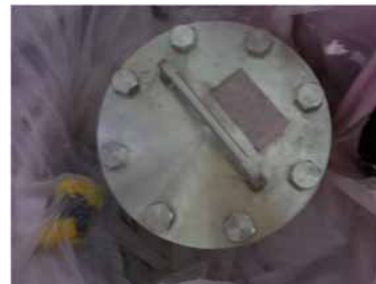
吸着塔3Aの点検口（漏えい箇所）
