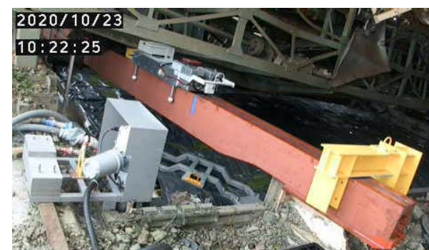
図2.転倒防止金具設置後の状況(10月23日撮影)
