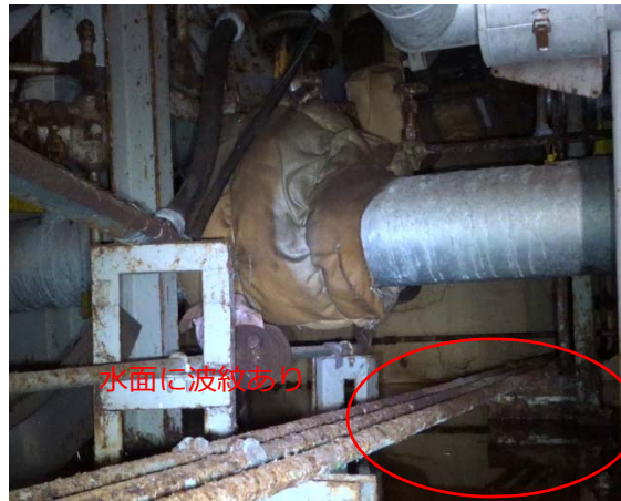
主蒸気系ドレン配管
