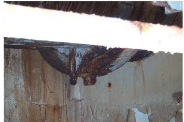
主蒸気配管 C
