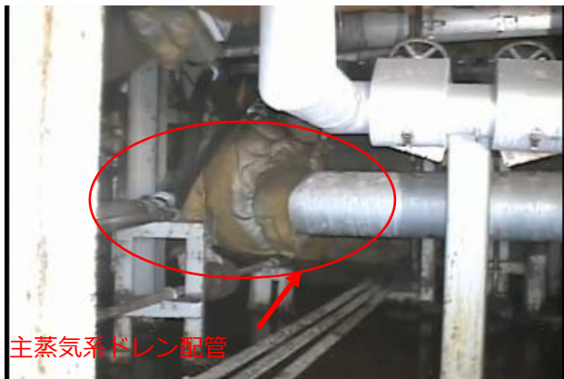
主蒸気系ドレン配管
