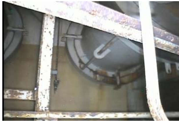
主蒸気配管 B
