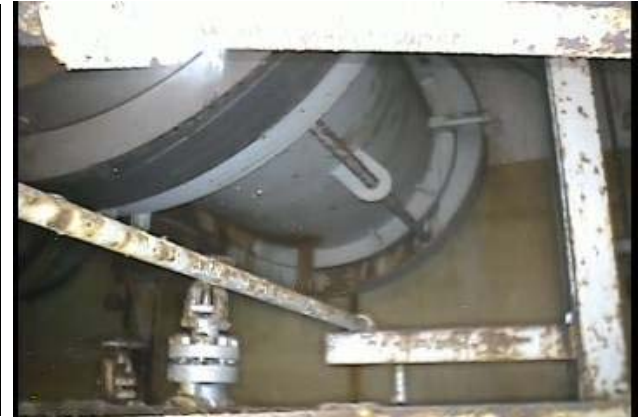
主蒸気配管 C
