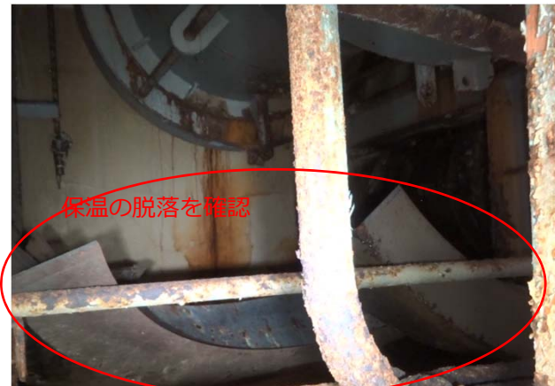
主蒸気配管 B
