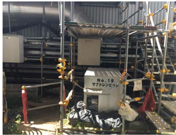
【サブドレンピットNo.19】
