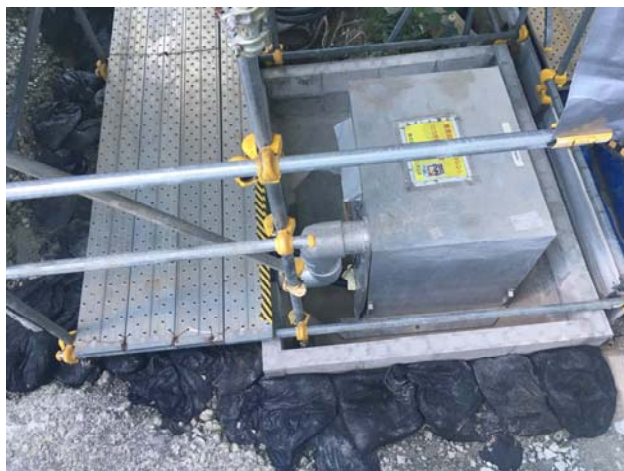
【サブドレンピットNo.18】
