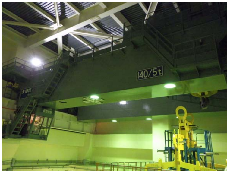
キャスク搬出入エリア天井クレーン 共用プール建屋へ搬入したキャスクを搬送台車へ乗せるために、1階に設置されてある天井クレーン
