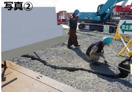
地表面の地割れ／地盤の沈下等
