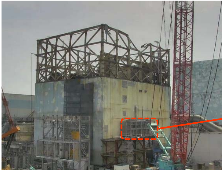
写真1.1号機原子炉建屋の状況（俯瞰）
