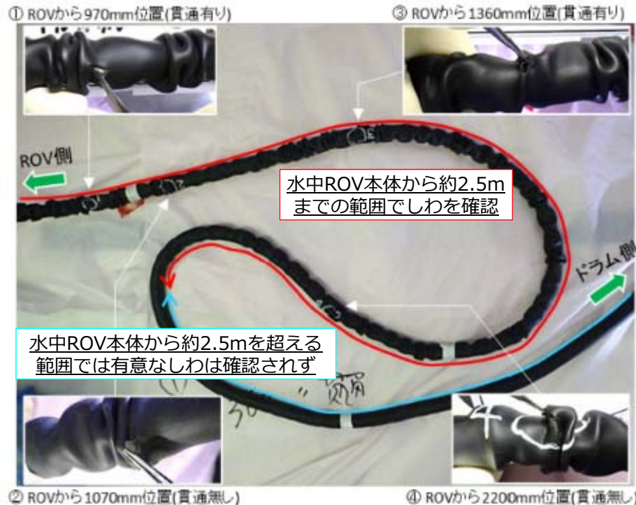
写真1.ケーブル被覆のしわの状況
