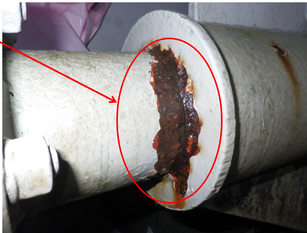
漏えい箇所 塗装剥離状況
