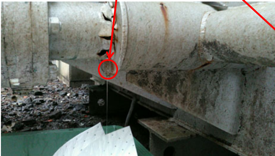
絶縁油漏えい状況
