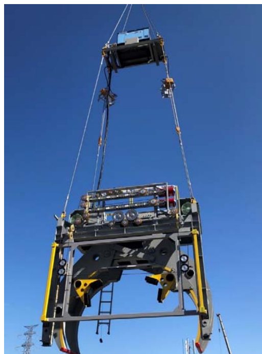
切断装置 全景 (撮影：2021年11月16日)
