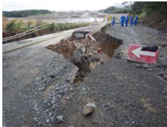
【Partial collapse of slope】
