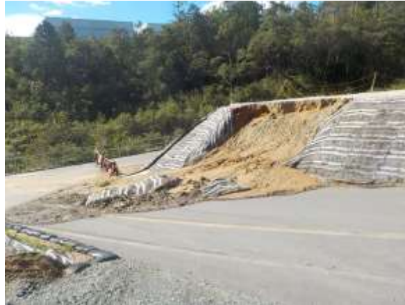
【Partial collapse of slope】
