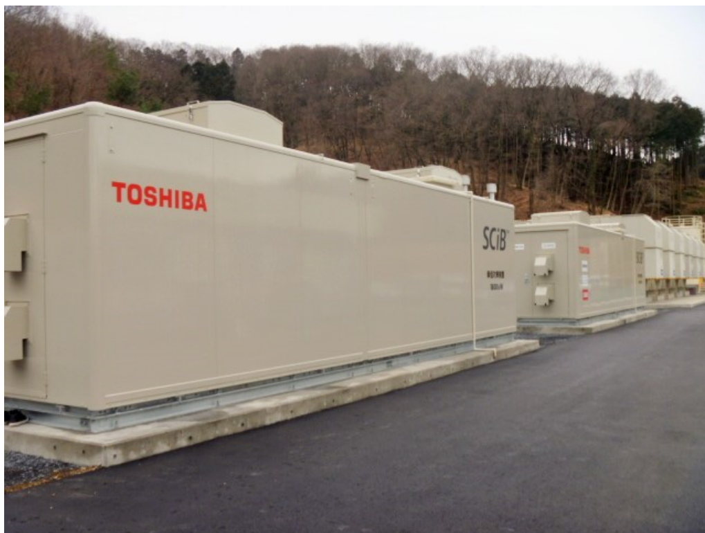
＜スバル研究実験センターに設置されたリチウムイオン蓄電池等＞
