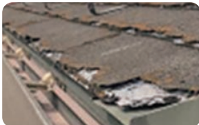
破損している
