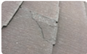
割れ・欠けがある
