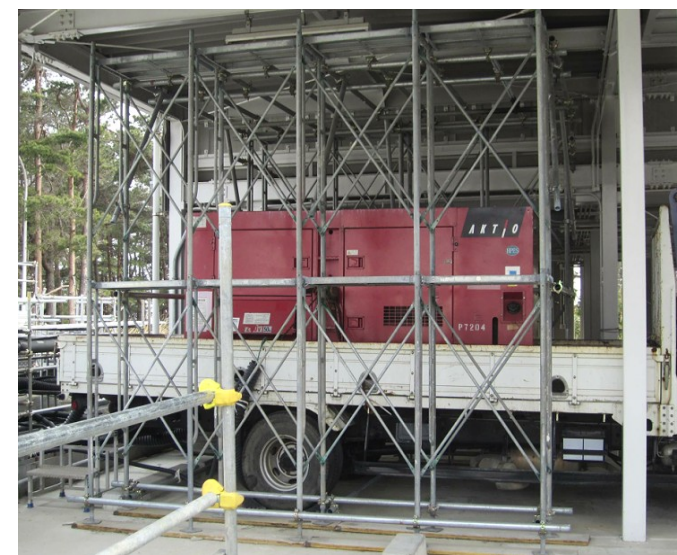
<非常用ディーゼル発電機>
