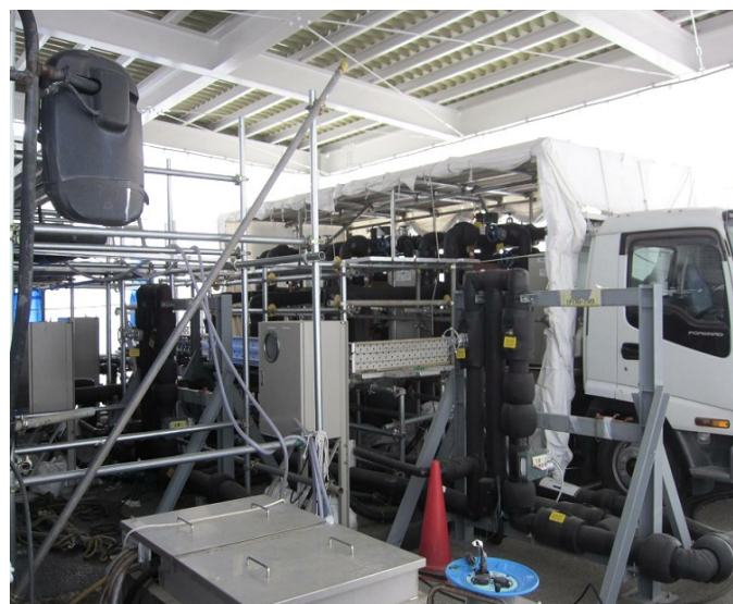
<非常用高台炉注水ポンプ>
