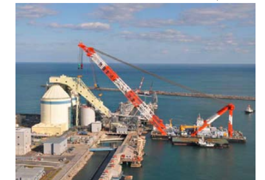
H24.11 石炭急傾斜コンベヤ上架(3,000t F/C)
