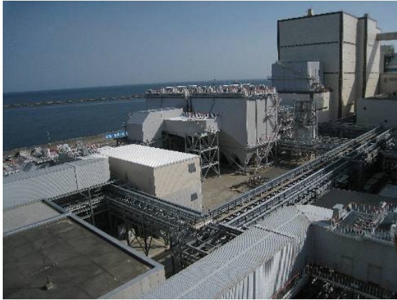
H25.3 ボイラー・排煙脱硝装置・電気式集じん装置
