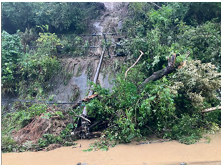
＜土砂崩れによる設備流出＞
