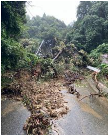
＜土砂崩れ箇所＞
