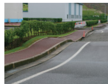
地震の影響を受けた発電所構内の道路
