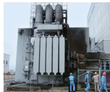
火災のあった3号機所内変圧器
