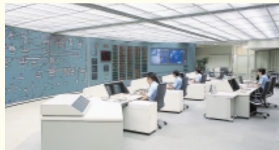
刻々と変化する電力需要にあわせて、電気の流れをコントロールする中央給電指令所
