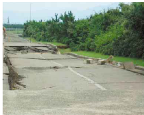
地下水位が高い海側の液状化 (1～4号機海側道路)
