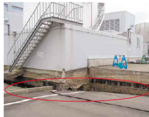
建屋の周辺が大きく沈下 (1号機・軽油タンク)
