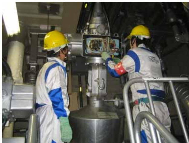
1号機 残留熱除去系弁の点検
