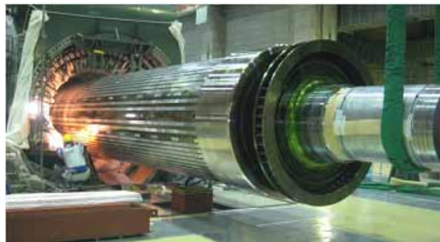
1号機 主発電機の点検
