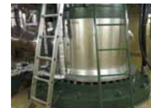
残留熱除去系 ポンプ 等
