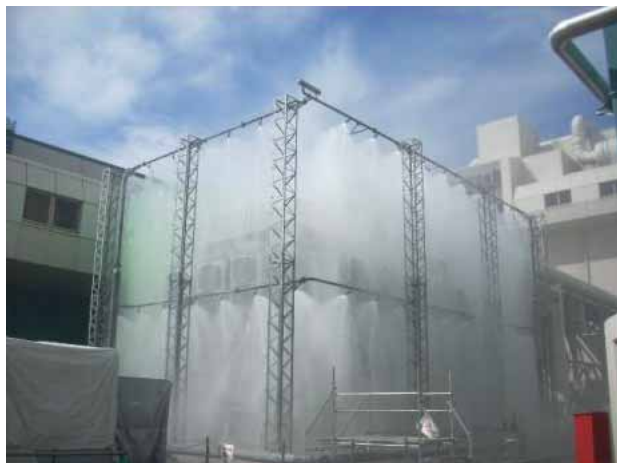
6号機 変圧器スプリンクラー試験
