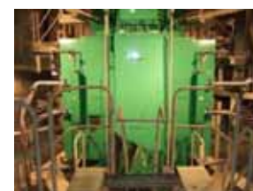
原子炉冷却材 再循環系ポンプ
