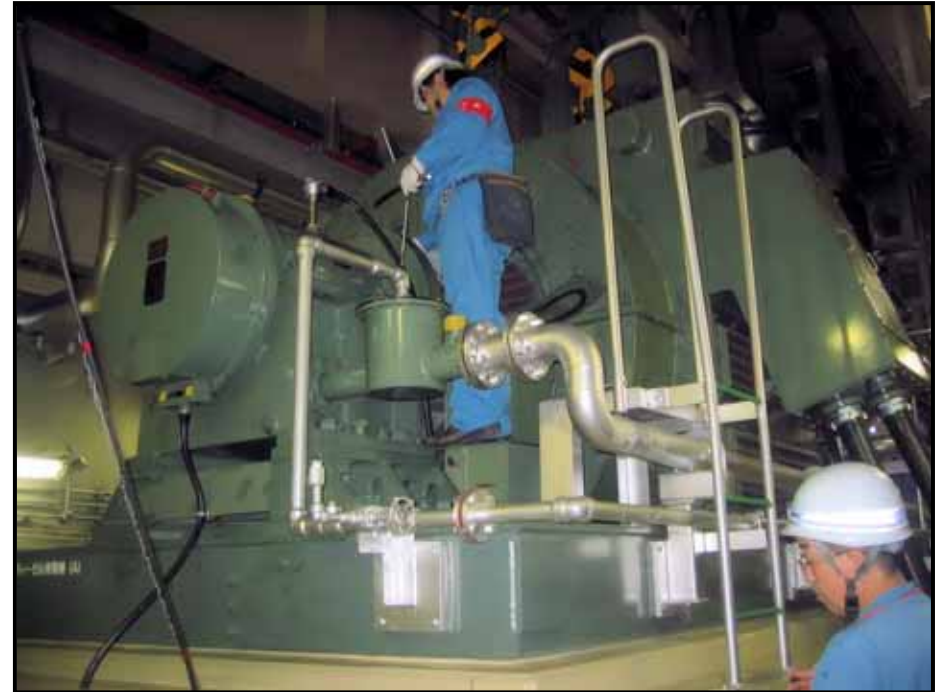
【 非常用ディーゼル発電機の点検 】
