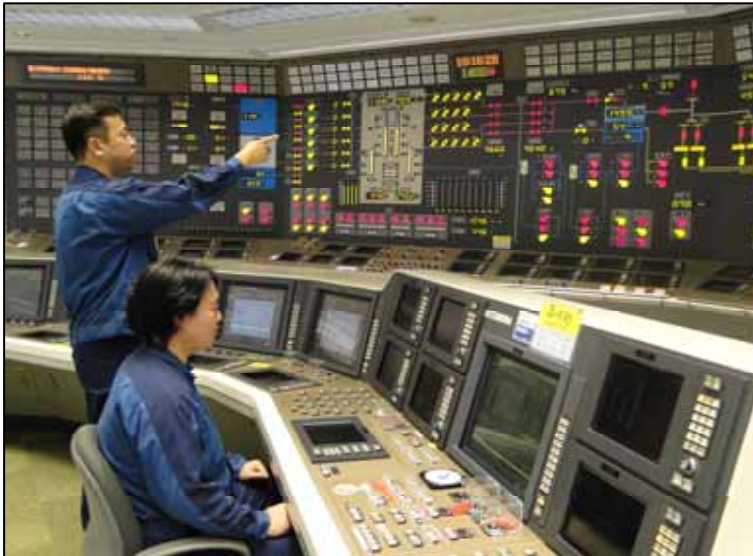
【中央制御室における運転操作の様子】
