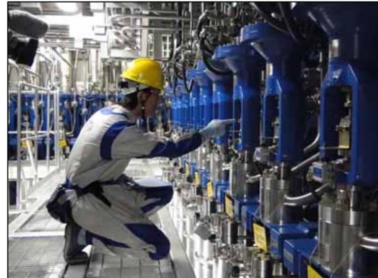
【運転員による現場パトロールの様子】
