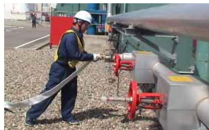
消防ホースの注水ライン接続
