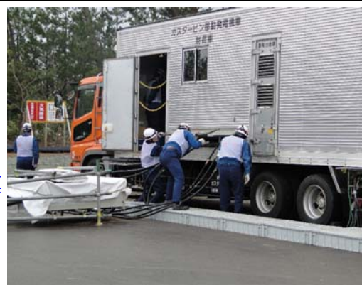
GTGによる電源供給訓練風景
