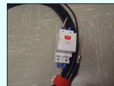
仮設操作スイッチ と仮設ケーブル
