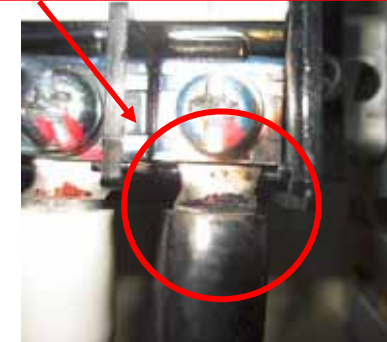
端子部詳細写真
