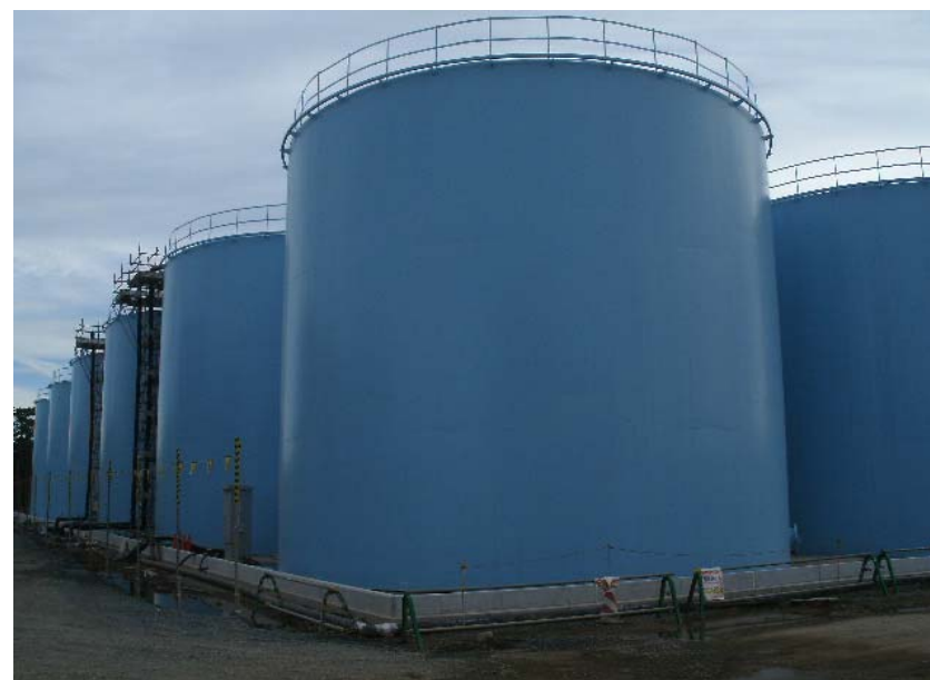
鋼製円筒型タンク (溶接)
