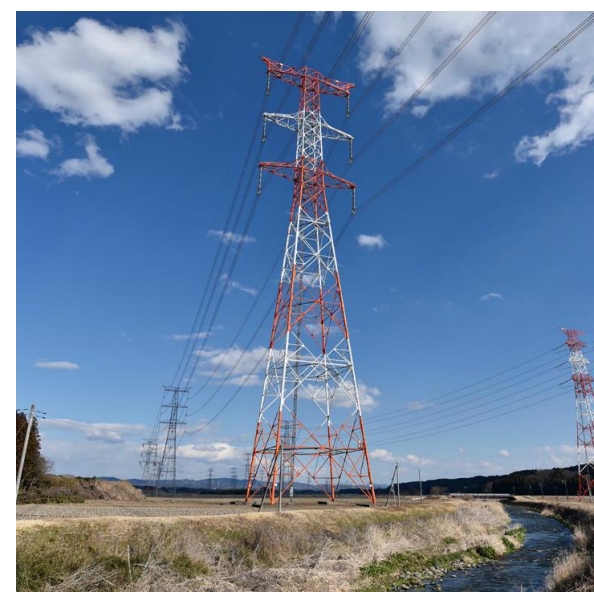
出典：東京電力パワーグリッドHP
