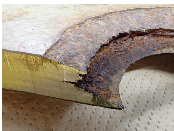
【配管切断面から見た欠損部】
