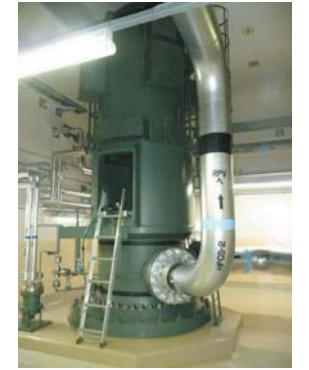
高圧注水系ポンプ
