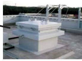
トップベント設備
