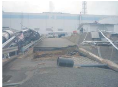
道路の陥没・がれき等で 車両の移動も困難に
