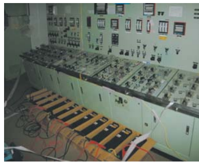
仮設バッテリー等をつなぎ 計器用電源として使用
