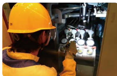
グリスの状態を確認している様子
