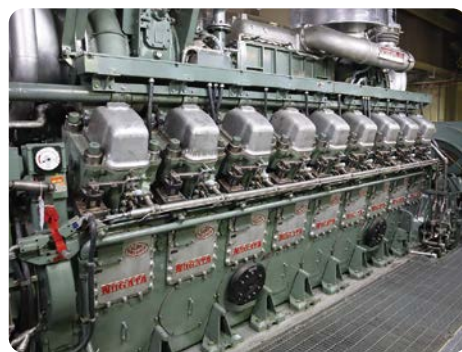
非常用ディーゼル発電機 外観
