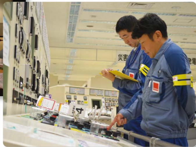
中央制御室で機器の状態を確認する運転員
