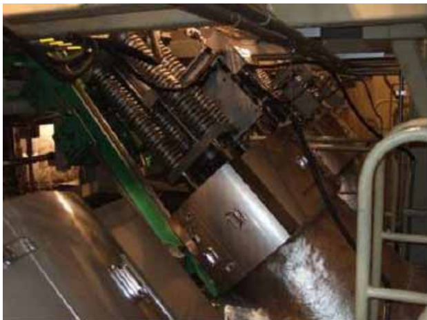
主蒸気隔離弁
