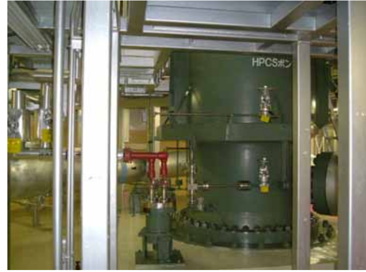
非常用炉心冷却ポンプ
