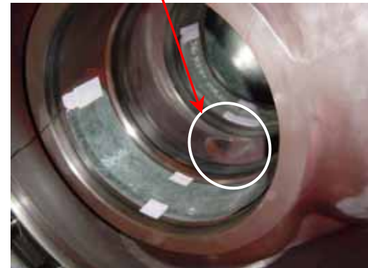
原子炉給水ポンプ欠損の状況
