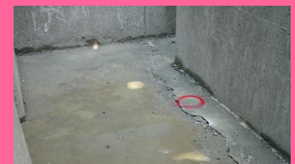
変圧器防油堤内のひび割れ
