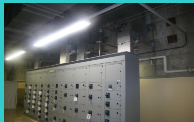
蛍光灯の落下
