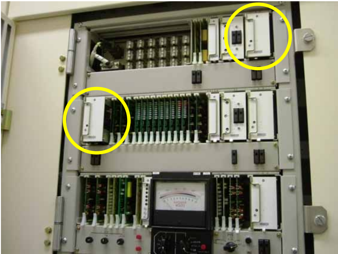
制御棒引抜監視装置制御盤内部
