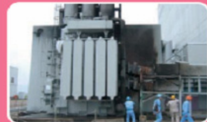
3号機所内変圧器の火災
