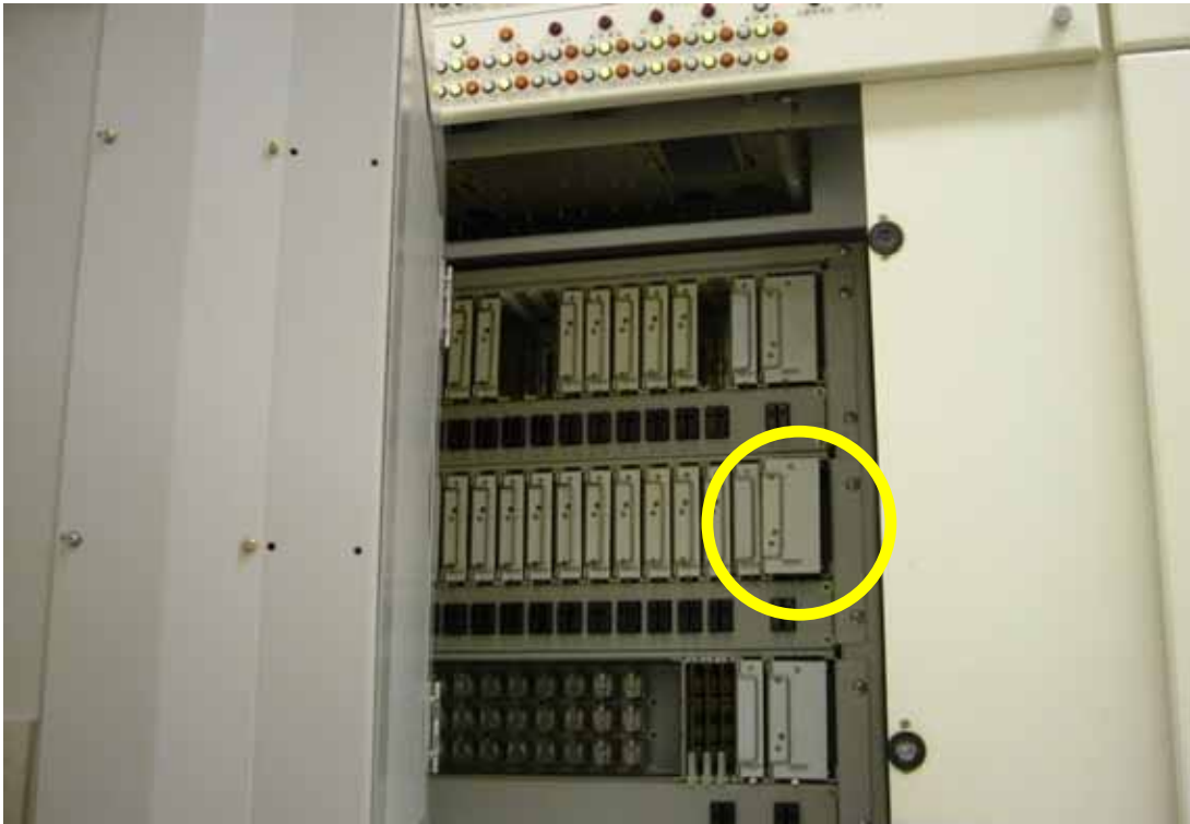
平均出力領域モニタ制御盤内部
