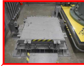
取水槽閉止板
