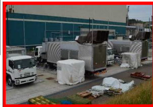
ガスタービン発電機
