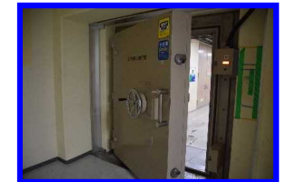
水密扉等の溢水対策 (屋内複数箇所)
