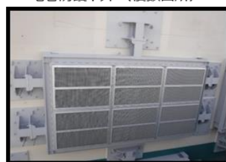
電巻防護ネット (複数箇所)
