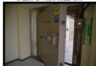
水密扉等の浸水防護対策
