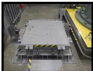
取水槽閉止板
