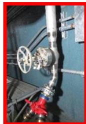
使用済燃料プールに注水するための外部接続口
