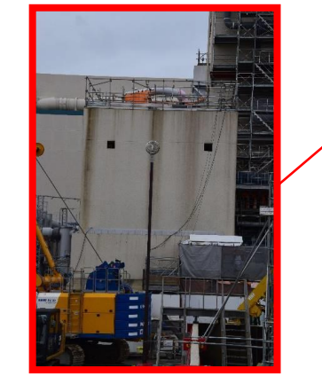
フィルタバント設備 (地上式)
