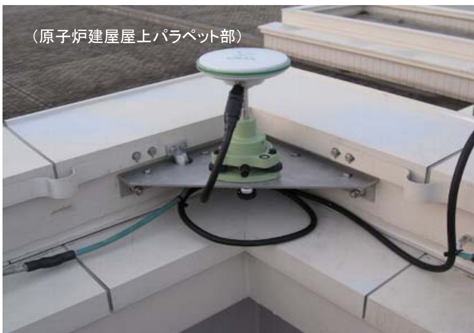
GPS受信器(原子炉建屋屋上)
