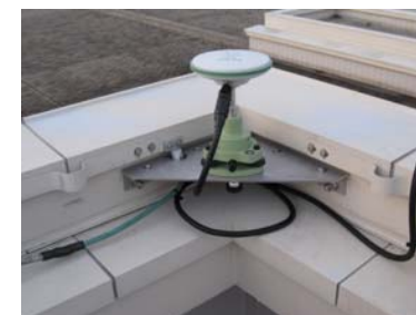
屋上GPS設置状況
