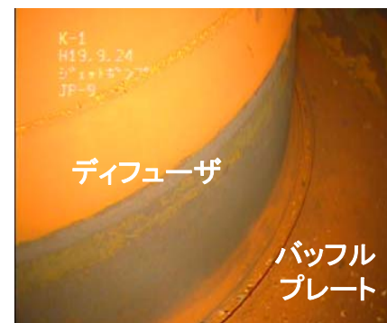
ジェットポンプ下部
