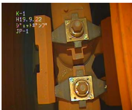
ジェットポンプ上部
