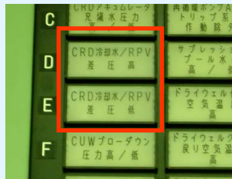
【CRD冷却水差圧高/低警報分離状況(2F1)】
